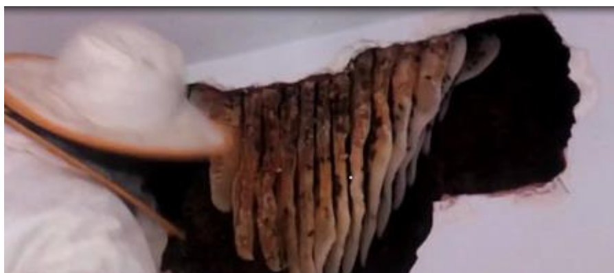
Operario municipal recogiendo panal en cámara de aire de vivienda.
